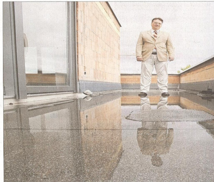
Der Gang auf die Terrasse bedeutet für Thomas Sørensen ein Fußbad. Schlimmer ist noch, dass das Wasser in die darunter liegenden Stockwerke sickert.
